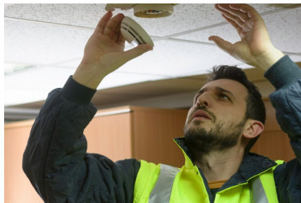
Comprobación y mantenimiento detectores
