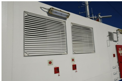
Cierres ventilación manuales
