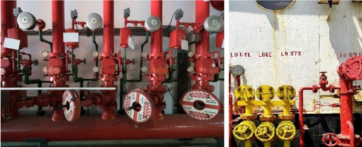
Válvulas de seccionamiento o corte de combustible
