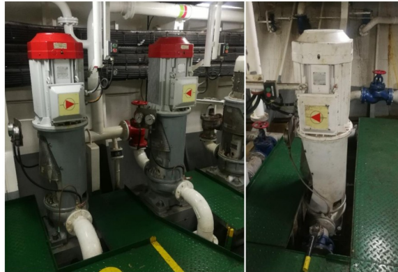
Bombas contraincendios a bordo y de emergencia
