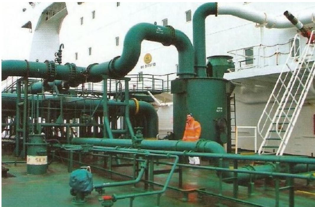
Instalación /Conducciones de gas y combustible
