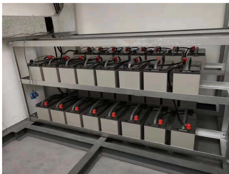
Pañol de baterías
