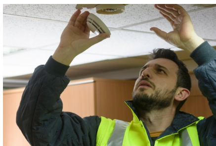
Comprobación y mantenimiento detectores
