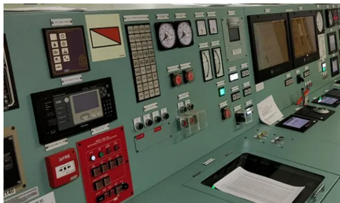
Control de máquinas
