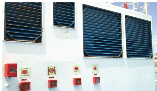
Conductos de ventilación de diferentes zonas del buque
