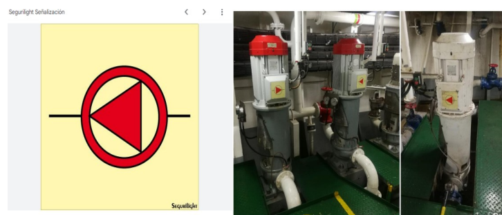
Bombas contra incendios y señal OMI correspondiente
