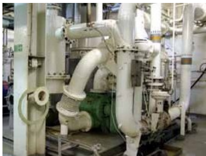
Planta de gas inerte a bordo
