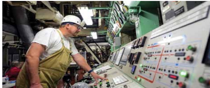
Control de los sistemas y alarmas
