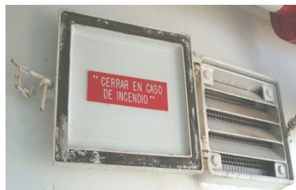
Cierre manual de ventilaciones
