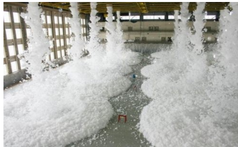
Sistema Fijo de Extinción con Espuma
