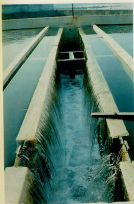
Pies de piscinas de depuración.
