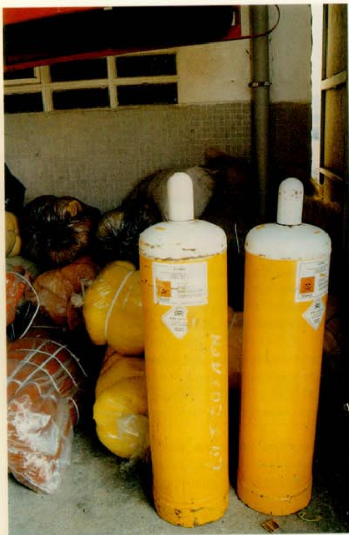
La adición de cloro al agua puede hacerse a partir de bombonas de cloro-gas o de hipoclorito.
