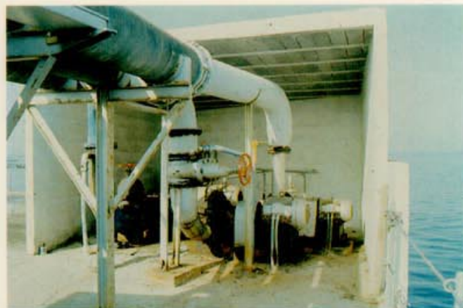
Desde el punto de toma, el agua se canaliza a través de grandes tuberías, adecuadas a los elevados caudales.
