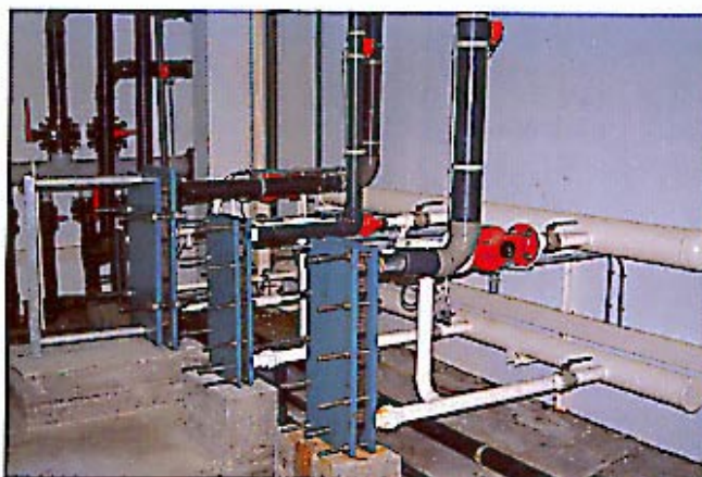
Serie de intercambiadores de calor de placas de titanio en un criadero industrial.
