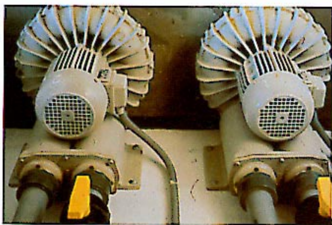
Soplantes para el suministro de aire al criadero.
