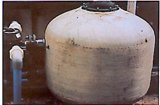
Filtro de arena industrial.
