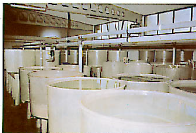
Disposición de las tuberías de aireación en una sala de larvas.
